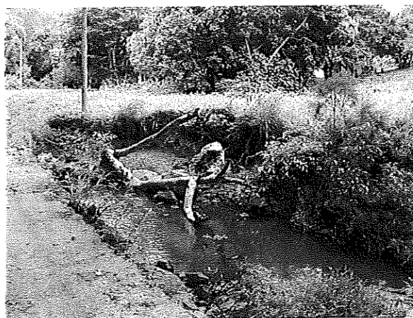
Photo n°6 : Erosion de la berge rive gauche de la Katiramon.
