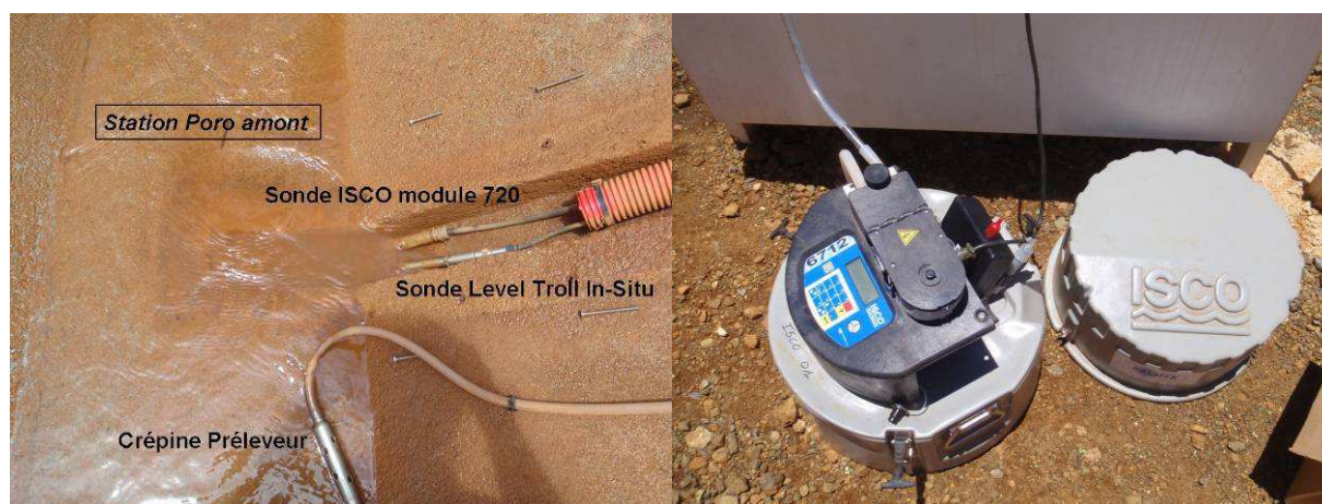
Capteurs à l'intérieur du canal
