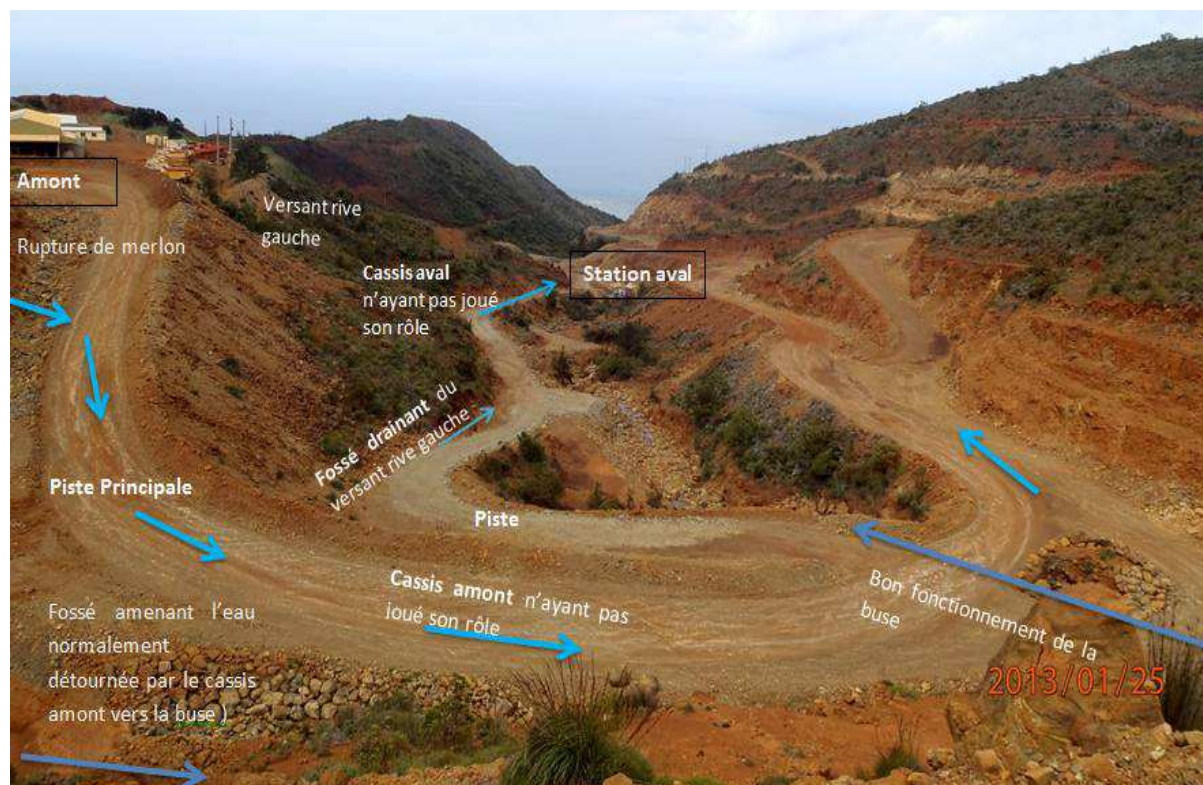
Figure 64 : Dysfonctionnement des ouvrages de gestion des eaux sur le bassin versant de Poro lors de la crue du 24 décembre 2011
