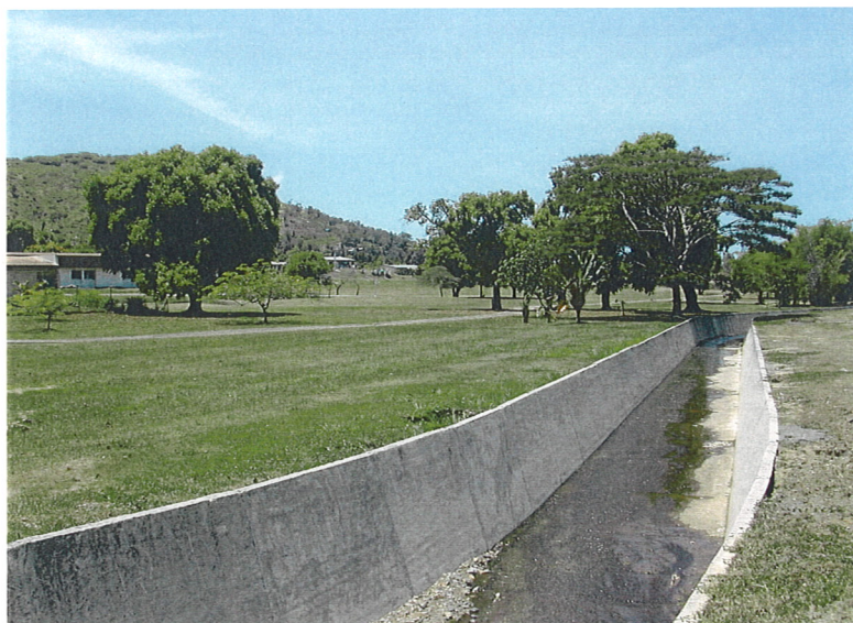
Photographie 6 : Le lit totalement cuvelé de la Namié, en aval du quartier Robinson.
