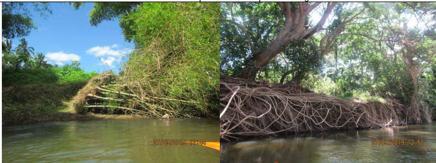
Traces (récentes ?) d'érosion de berge sur le secteur à l'aval du pont de la RT1
