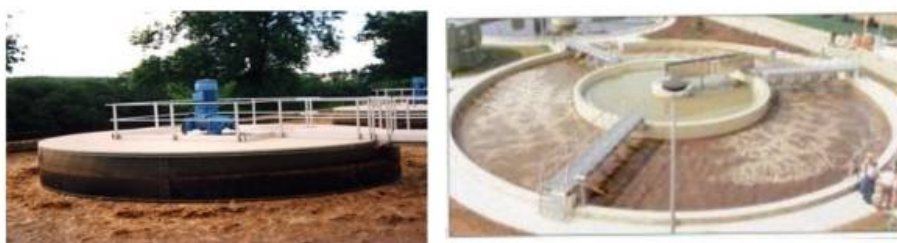
Photos : Source CDE (Calédonienne Des Eaux, filiale du groupe SUEZ environnement).
