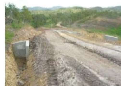
Photo n°5 : Passage busé d'évacuation du fossé de piste avec tête de buse en béton armé en « L » à l'entrée et droite à la sortie (Périmètre de Foni boy)
