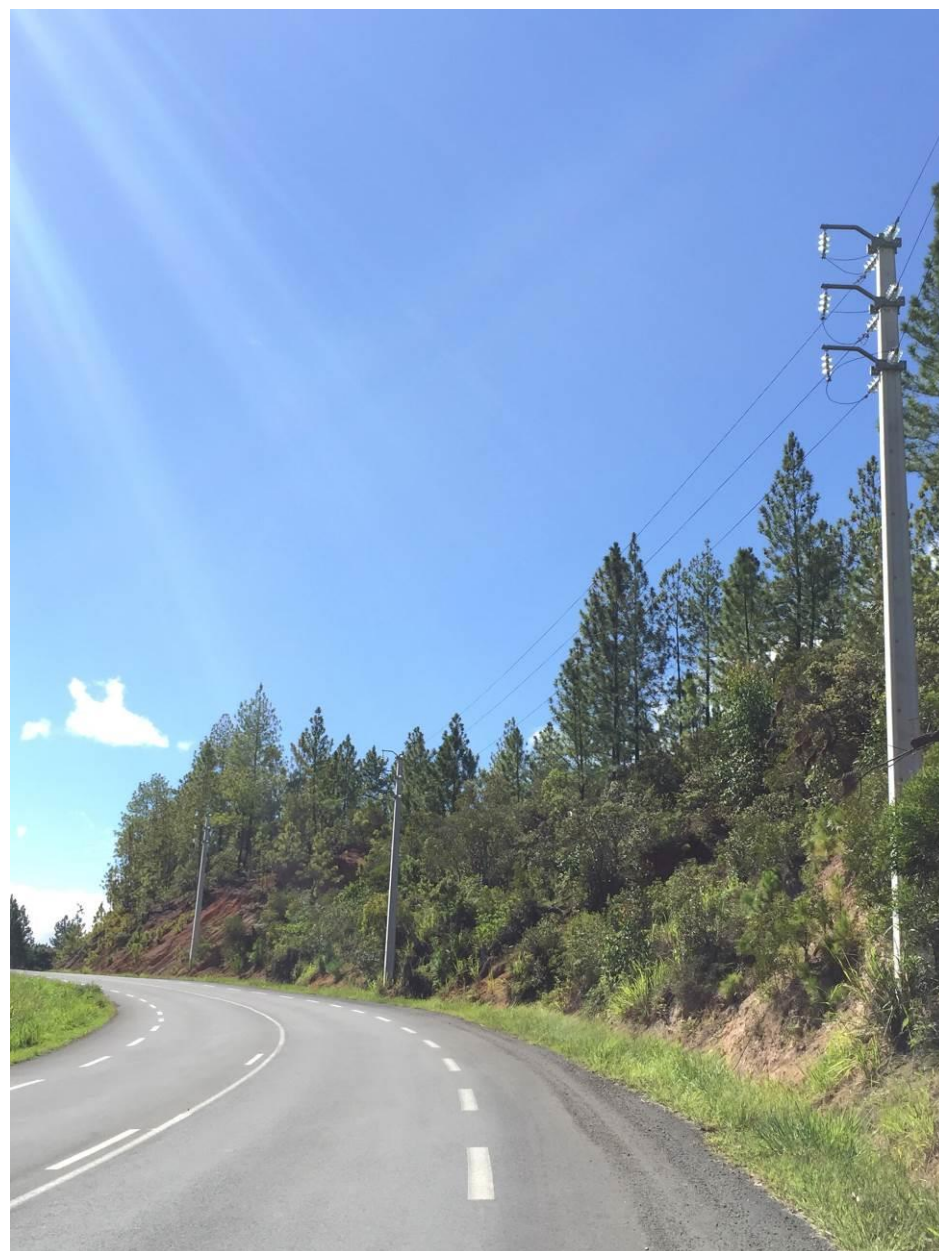
Poteau en « drapeau » - ligne HTA
