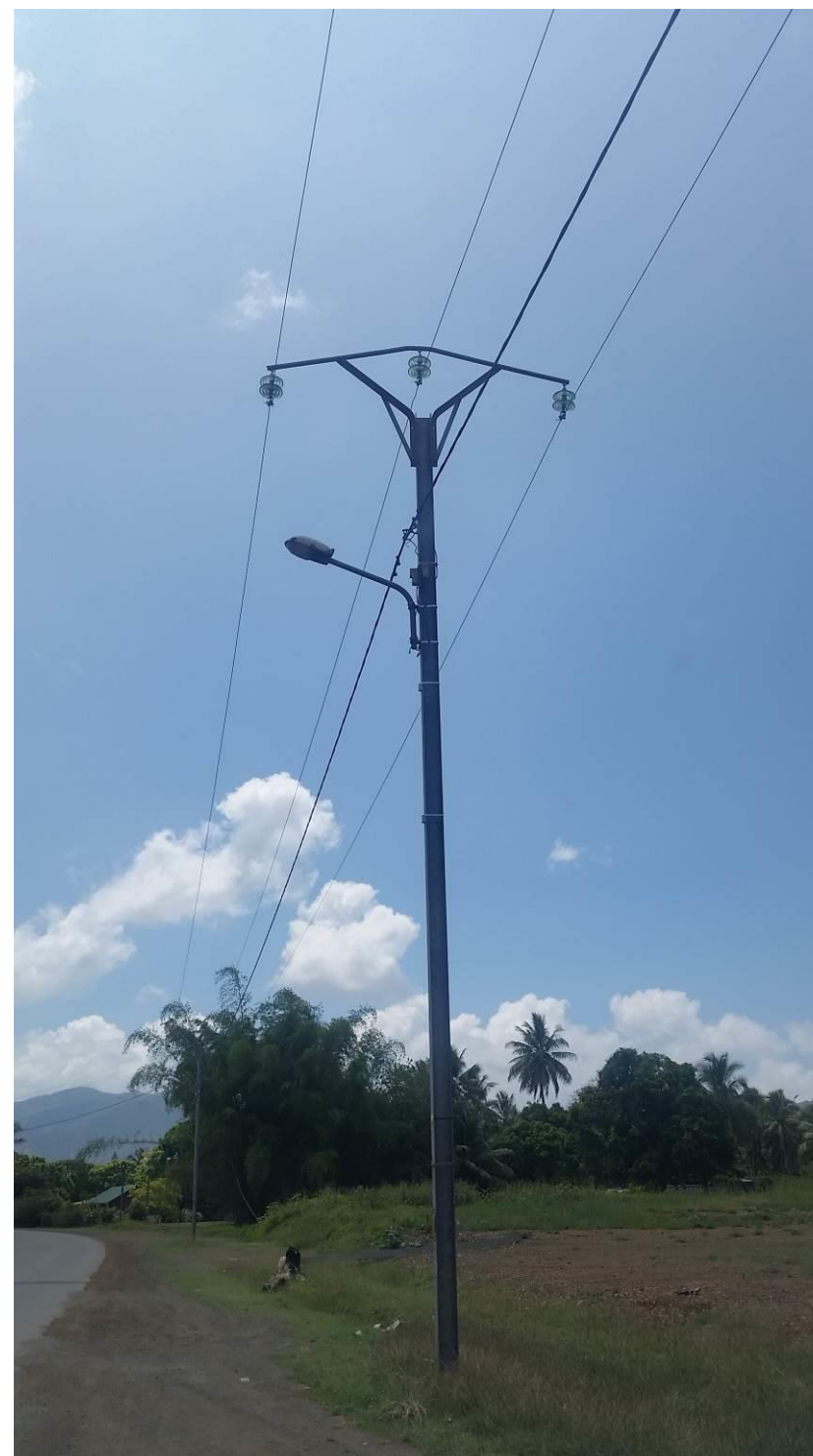
Poteau en « nappe voute » - ligne HTA
