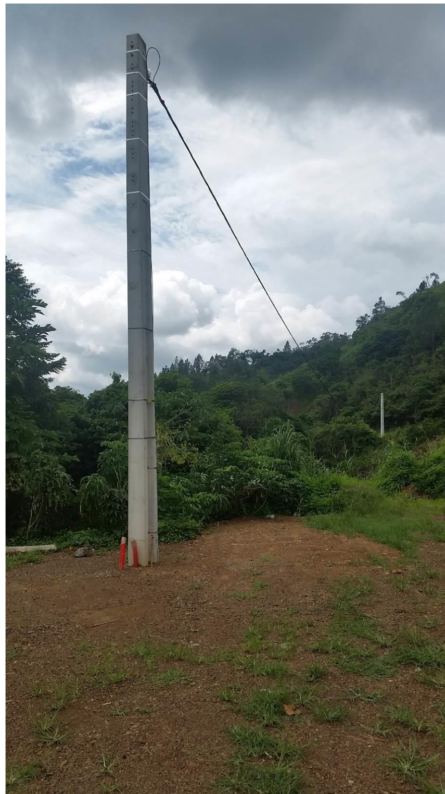
Poteau de ligne BTA pour la desserte des foyers
