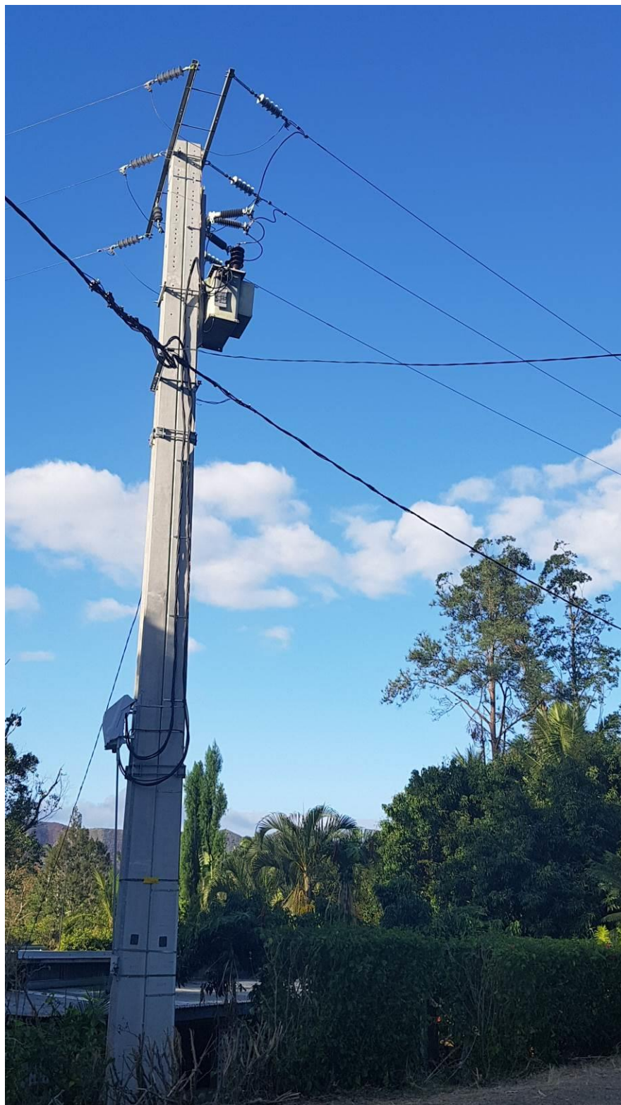
Poteau en « traverse » avec transformateur - ligne HTA
