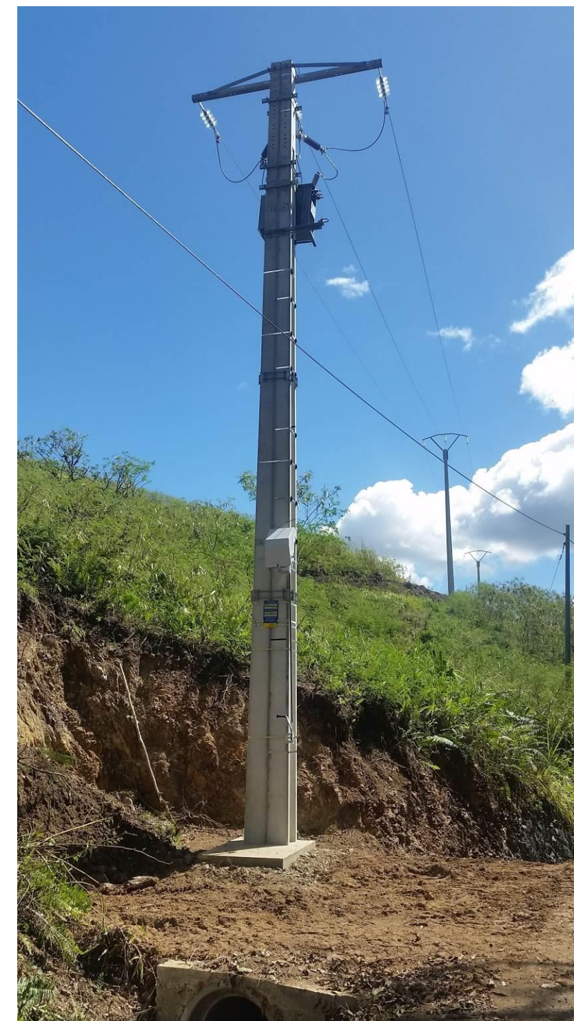
Autre type de poteau en « traverse » avec une emprise plus importante (entre 1m 2 et 3m 2 d'emprise de fondation)- fin de ligne HTA avec transformateur
