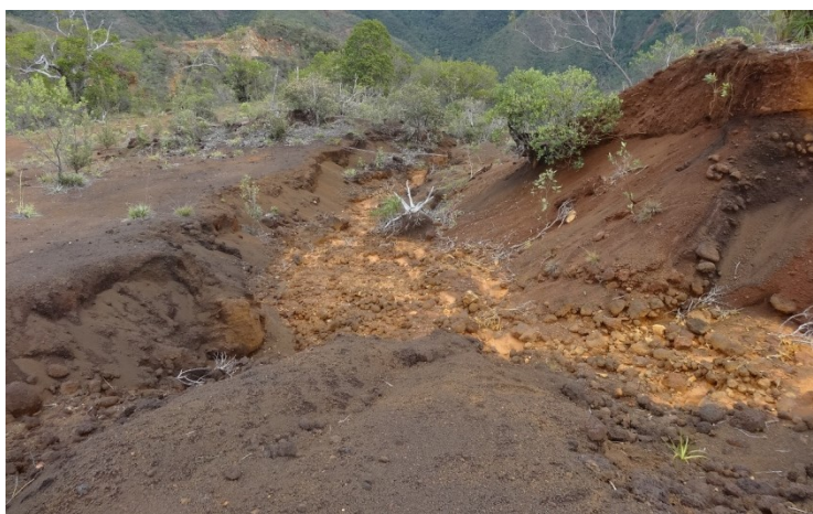
Photo 8: ravinement du chemin hydraulique avant exutoire du bassin versant C (Ecosysmine, novembre 2017)
