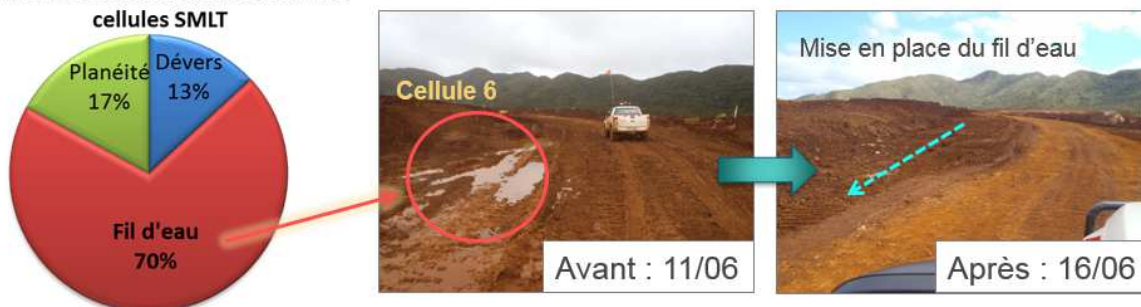
Figure 7 : Statistiques des non-conformités : exemple de GDE sur les cellules de SMLT
