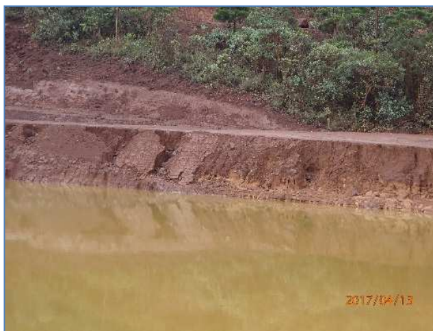
Figure 77 : Zones d'érosion sur le bassin BS11 suite au passage du cyclone Cook
