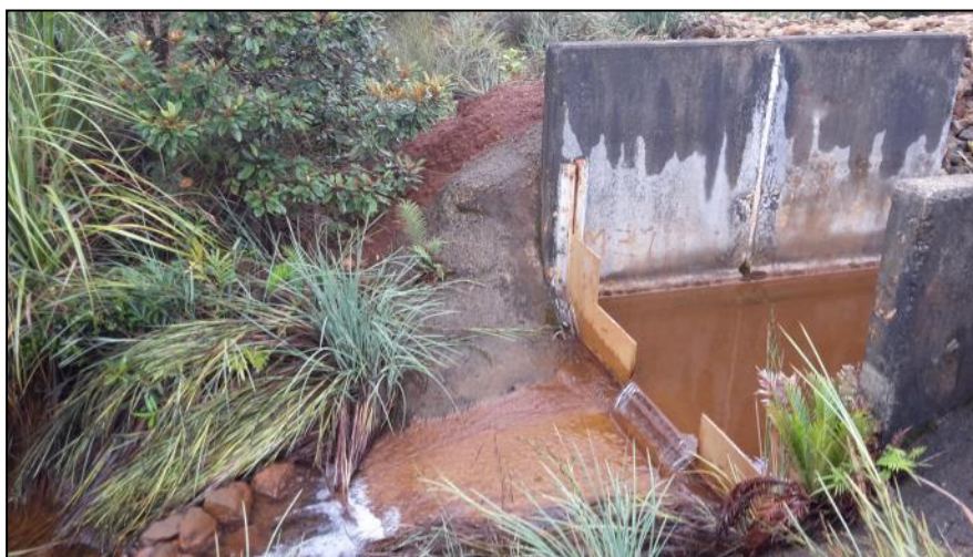
Figure 28 : Ouvrage de mesure du débit avec seuil (Photo : terrain Néodyme 26/12/2016)
