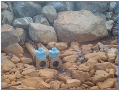
Vanne de vidange Du BS3
