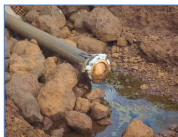
Vanne de vidange du BS1
