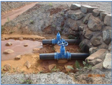
Vannes de vidange du BS6
