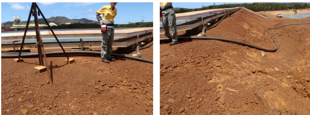
Photo 3 : Traces de débordements observés au niveau du bassin d'eau brute lors de la prospection du 1 er mars 2011.
