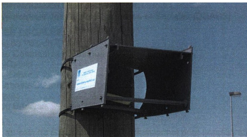
Figure 4. : Exemple d'implantation d'un tube dans son abri de protection
